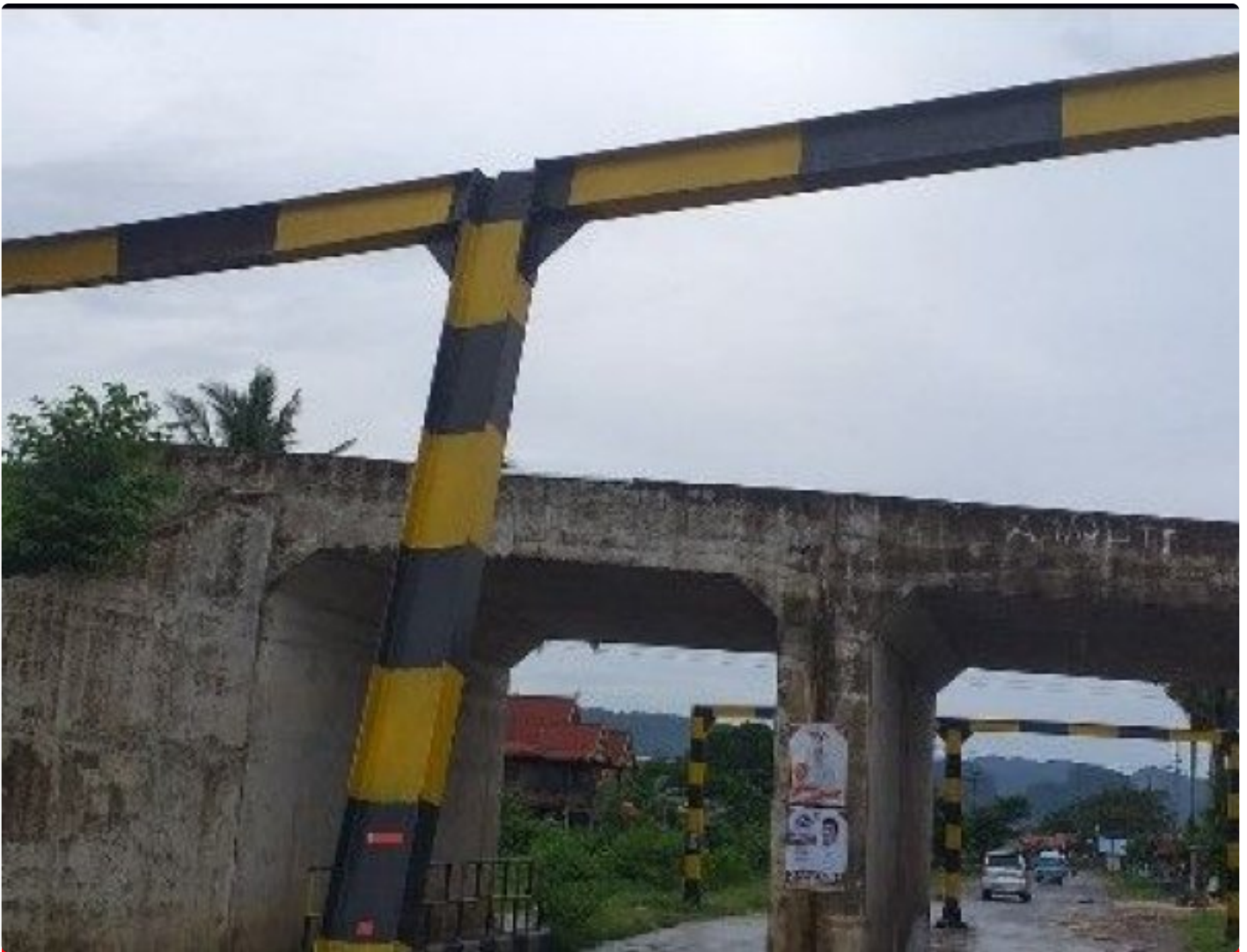
Pembatas Tiang Underpass Rel Kereta Api Jalan Tonasa Satu Soreang Baahayakan Pengguna Jalan
