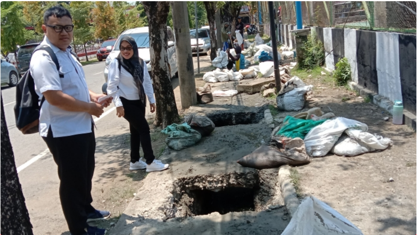
Kabid Cipta Karya PUK Pangkep Hariyanti pantau pembersihan got di jalan Cendana Kecamatan Pangkajene Kabupaten Pangkep
